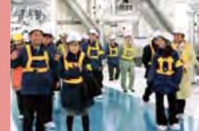
地蔵冷蔵房機械室内
